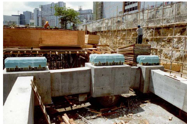
Wibroizolatory zainstalowane na kolumnach
