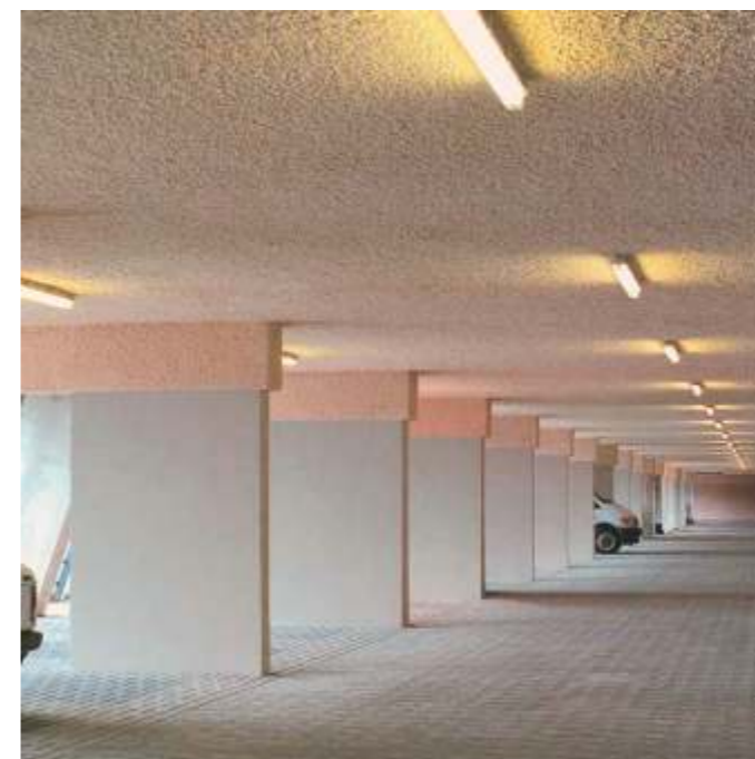
K-13 w garażu podziemnym dla uzyskania prawidłowych warunków akustycznych.
